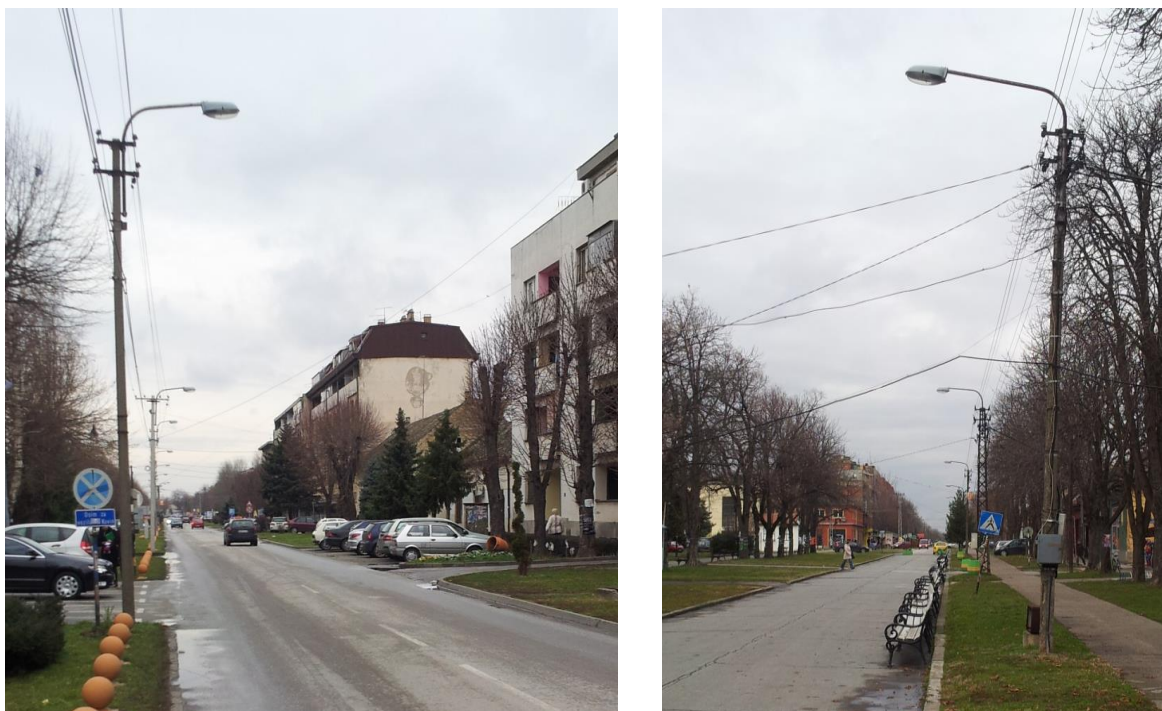
Slika 2. Izgled Instalacija JO u Ulici JNA (levo) i Cara Lazara (desno)
